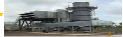
97 MW Avion First Gen/ IPP
