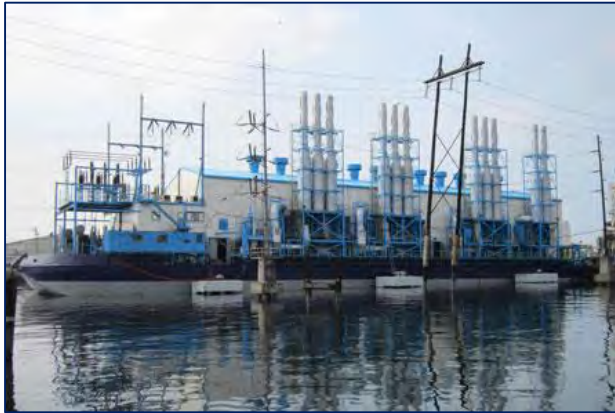
242 MW TMI Therma Mobile Power Barges (Navotas)
